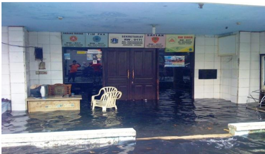
Gambar 1. Kondisi Kantor Rukun Warga 017 Kampung Muara Baru saat banjir rob 2013
