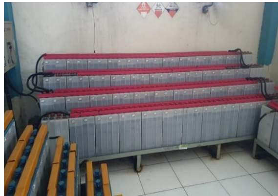
Sumber: PT PLN (Persero) Unit Gardu Induk Kedung Badak
