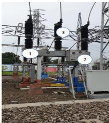
Sumber: PT PLN (Persero) Unit Gardu Induk Kedung Badak
