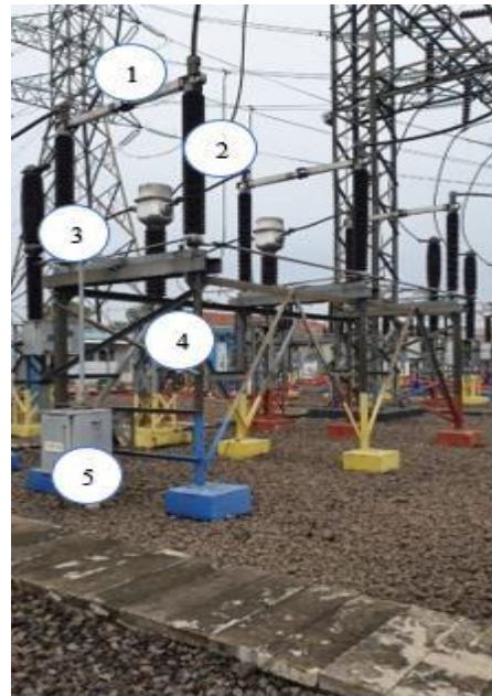
Sumber: PT PLN (Persero) Unit Gardu Induk Kedung Badak
