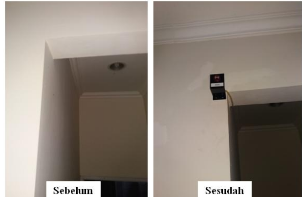
Gambar 11 lampu dan buzzer alarm
