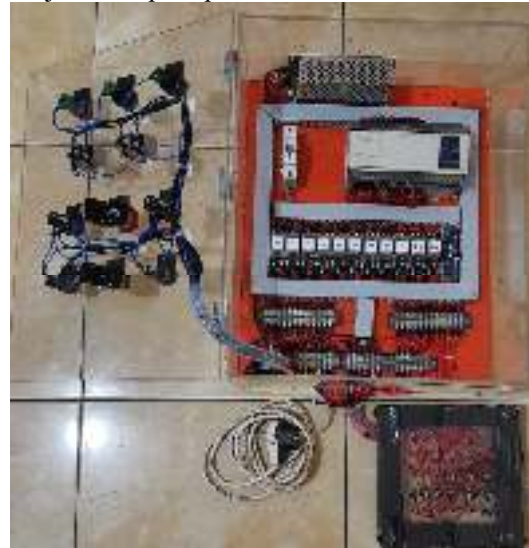
Gambar 5 bentuk fisis panel dan terminal-terminal penghubung
