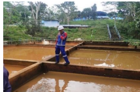
Gambar 1. Kolam Penampungan Limbah Perumda Tirta Menuntung (Sumber : Dokumentasi Pribadi)
